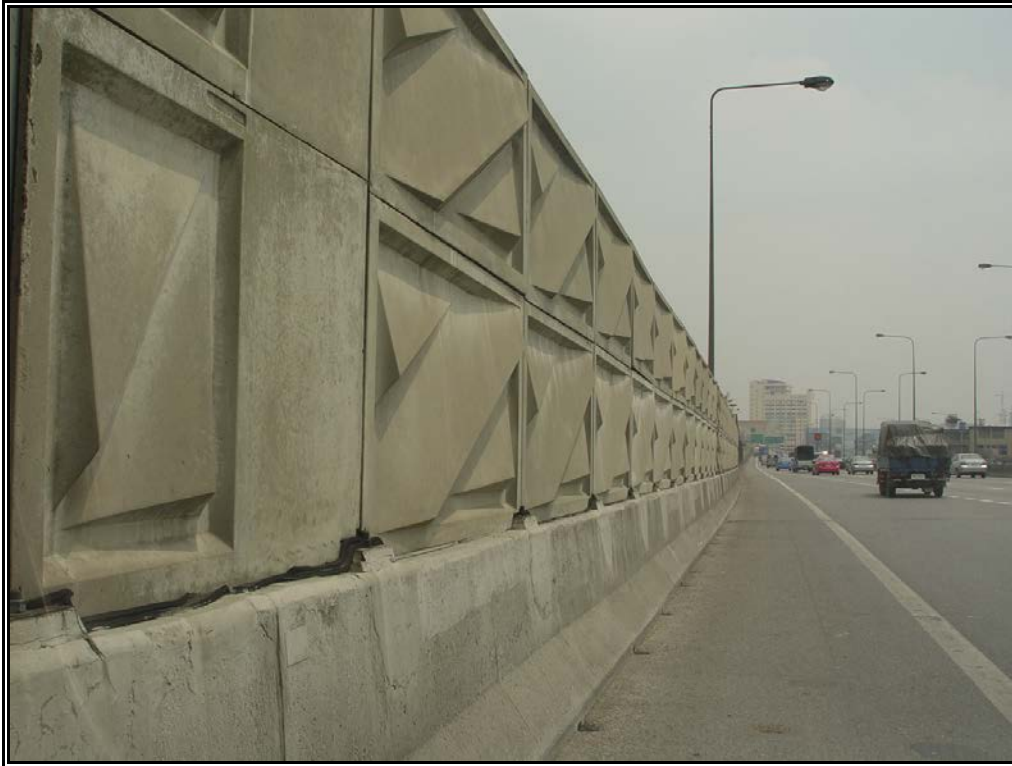
รูปที่ 3.14 กำแพงกั้นเสียงบริเวณแพลตฟอร์มการรถโดยสารสาธารณะ คลองเตย
